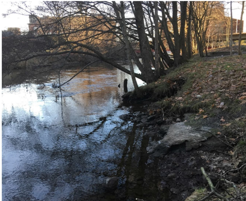
Figur 5. Pågående erosion vid ca sektion 160N. (2021-12-20)
